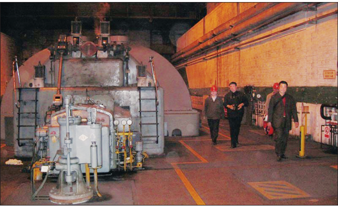
地下电厂的设备早已闲置。
