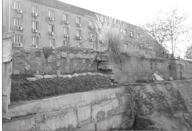
明代古城墙垮塌及裂缝倾斜段达12米
