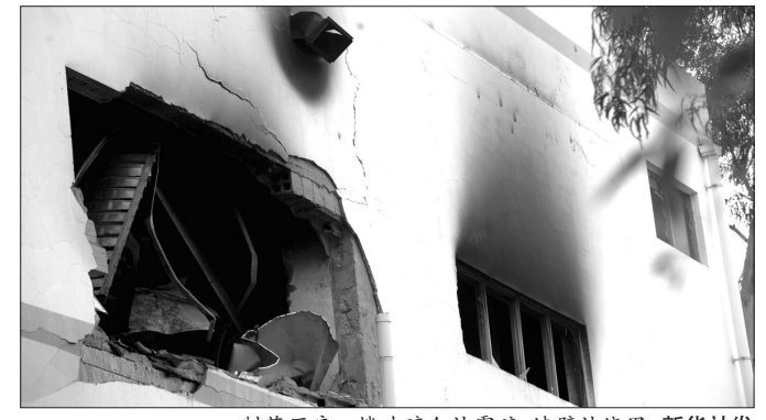
制药厂四楼玻璃全被震碎,墙壁被烧黑 新华社发
