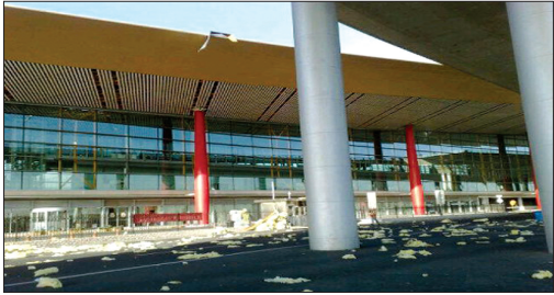
T3航站楼屋顶铁皮内的隔热泡沫被吹了一地
